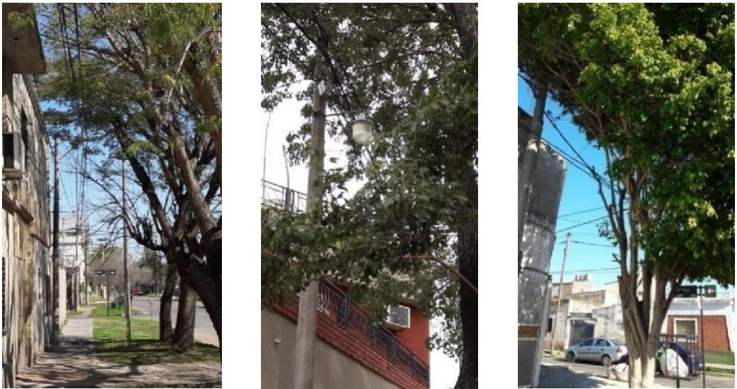
Interferencia de árboles con cables de energía eléctrica y telefónica.
