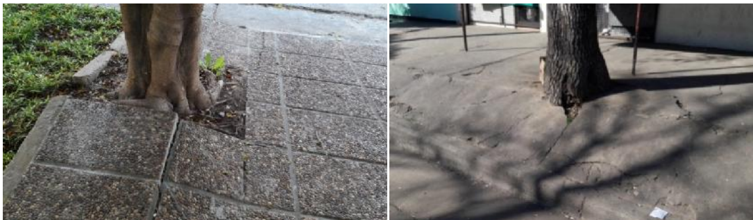
Árboles rodeados de cobertura impermeable levantando vereda.
